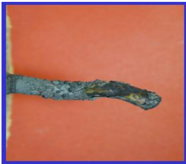
Bild 2: Durch Schwefelkorrosion zerstörter Ankerstift
