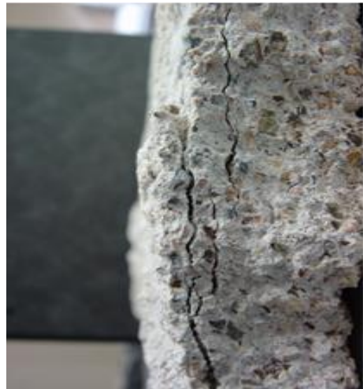
Bild 1: Durch Alkalikorrosion zerstörtes Ausbruchstück einer feuerfesten Auskleidung
